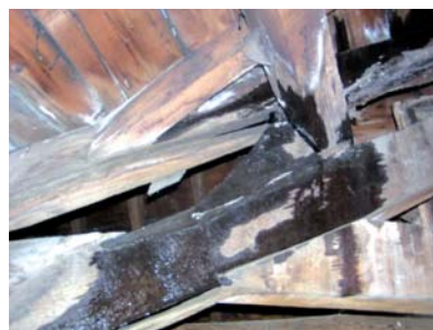
infiltration en toiture
