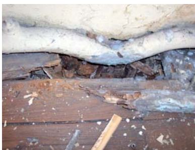
fuite de canalisation
