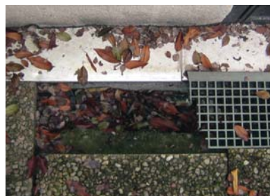
égout à nettoyer
